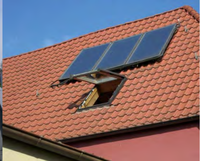
Solarthermieanlage in der Altstadt
